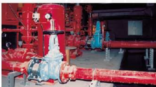
消防機房 16K閥使用實例
